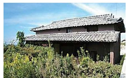
老朽化した空き家
