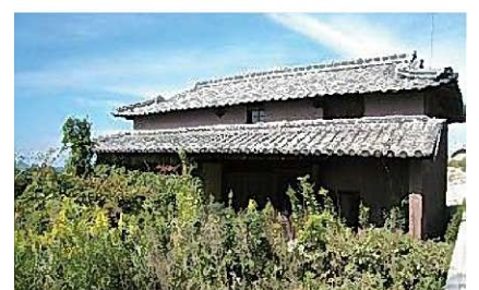
老朽化した空き家
