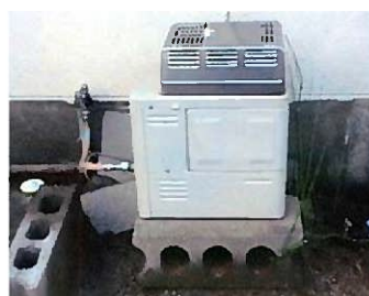
町営住宅の浴室設備
