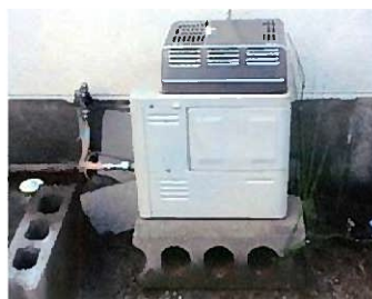
町営住宅の浴室設備
