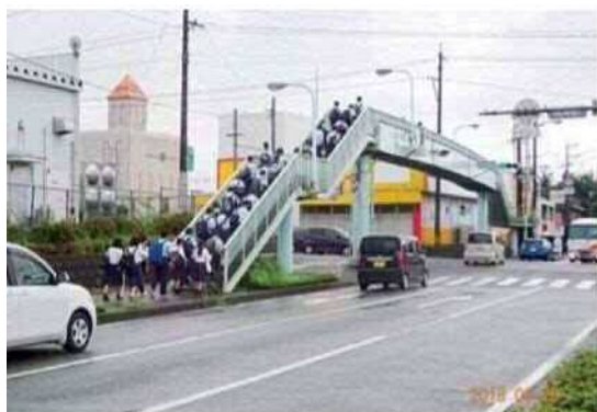
大津バイパス歩道橋 (築46年経過し相当傷んでいます)
