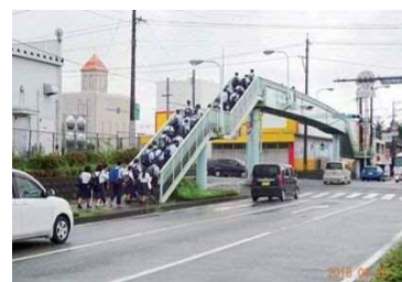
大津バイパス歩道橋（築46年経過し相当傷んでいます） 朝の通学風景、大津中・大津高校の学生300～400人が利用しています
