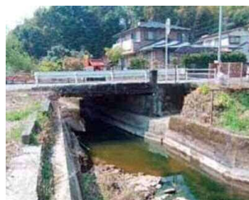
改修予定の鶴口橋
