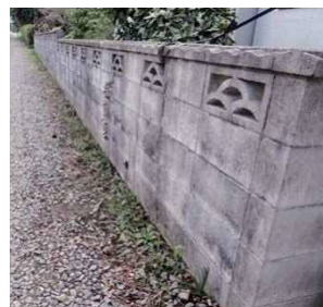
通学路に点在するブロック塀
