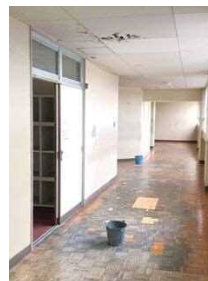
町内の学校の雨漏り
