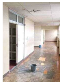
町内の学校の雨漏り
