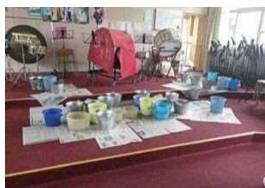
学校の雨漏り時の状況
