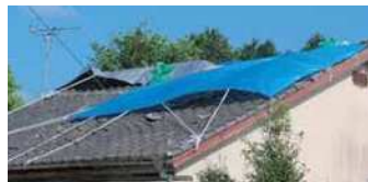
現在の基準で、屋根が壊れただけでは、一部損壊判定
