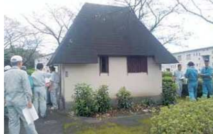
老朽化の目立つ昭和園トイレ
