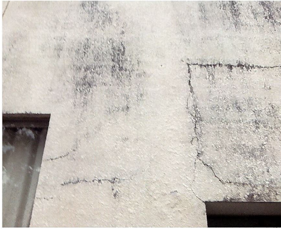
南小学校の老朽化した外壁
