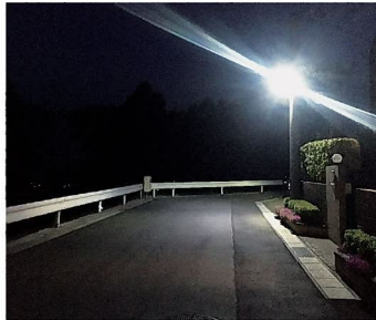
LED化された街灯
