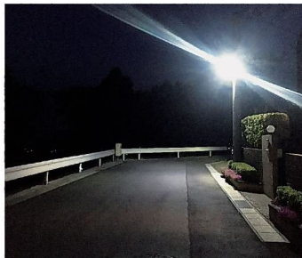
LED化された街灯
