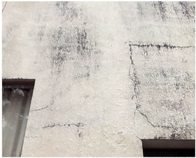
南小学校の老朽化した外壁
