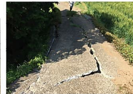
農業用道路の損壊
