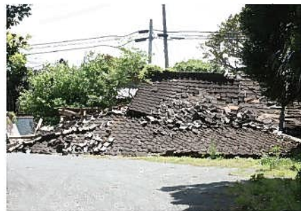
高尾野地区(建物被害)
