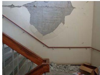
階段RC壁、クラックおよびモルタル剥離。
