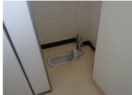
衛生器具が老朽化している。男女トイレとも、洋式便器は無く、和式のみ。
