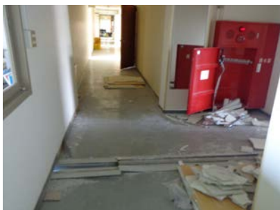
エキスパンション・ジョイント部の破損。
