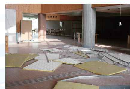
□岩戸の里温泉の被害状況
