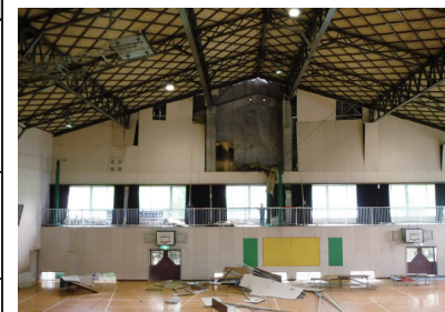
〔大津南小学校体育館の被災状況〕
