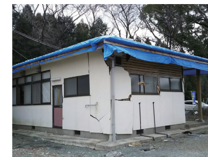
□地域集会所の被害状況（新小屋集会所）
