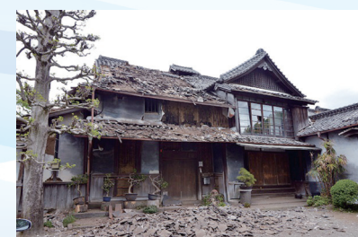
□江藤家住宅の被害状況
